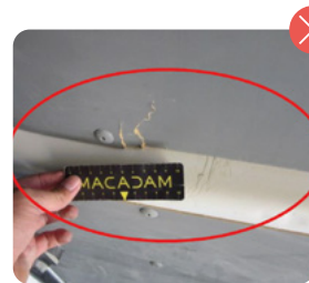
Panel zona de carga roto
