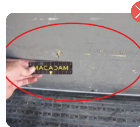
Panel zona de carga roto
