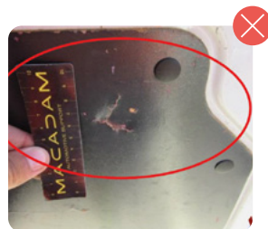
Panel zona de carga roto
