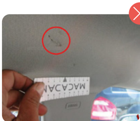
Rotura revestimiento techo
