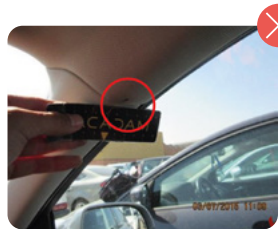
Quemadura revestimiento techo
