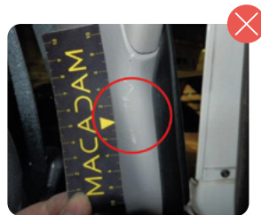
Rayado revestimiento pilar
