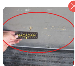
Panel zona de carga roto
