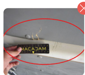
Panel zona de carga roto
