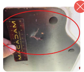
Panel zona de carga roto
